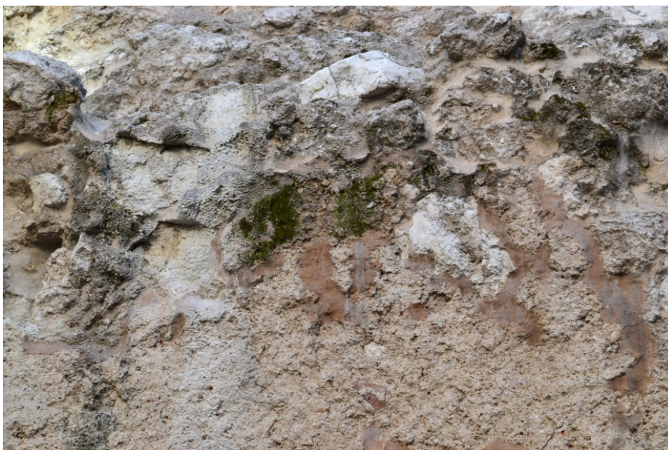
Fig.30: las humedades y los líquenes deterioran los restos de muralla
