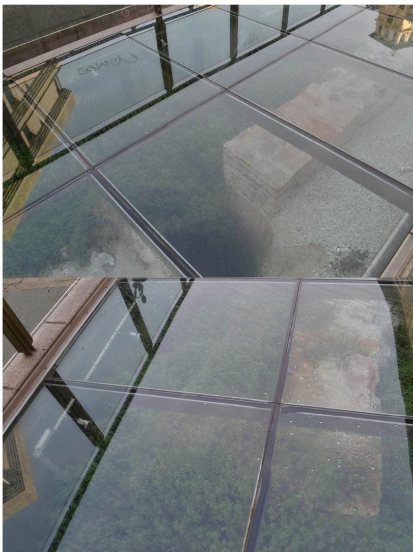
Fig.42: La falta de mantenimiento es evidente, pues de lo contrario se hubiera controlado el crecimiento de vegetación.
