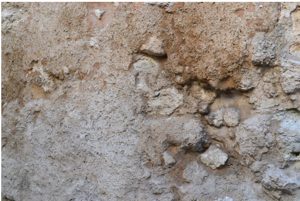
Fig.29: ejemplo de daño antrópico al usar mortero sintético en la restauración de 2002.
