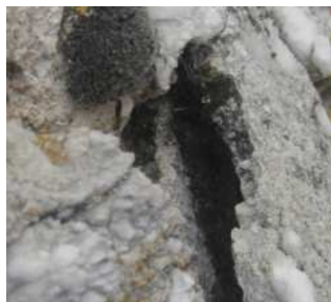
Fig. 163. Desprendimiento del revoco. Musgos y líquenes. Fotografía de la autora.
