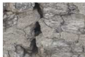
Fig. 161. Grietas en el muro. Fotografía de la autora.
