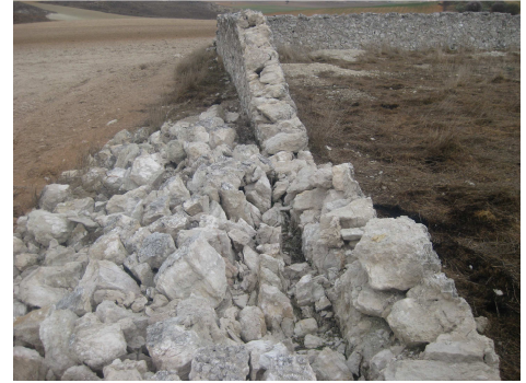
Fig. 166. Derrumbe y pérdida verticalidad
