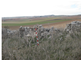
Fig. 194. Biodeterioro y pérdida de mampuestos
