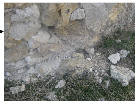
Fig. 155. Arenización y pérdida mampuestos
