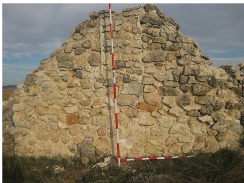
Fig. 211. Biodeterioro e inestabilidad
