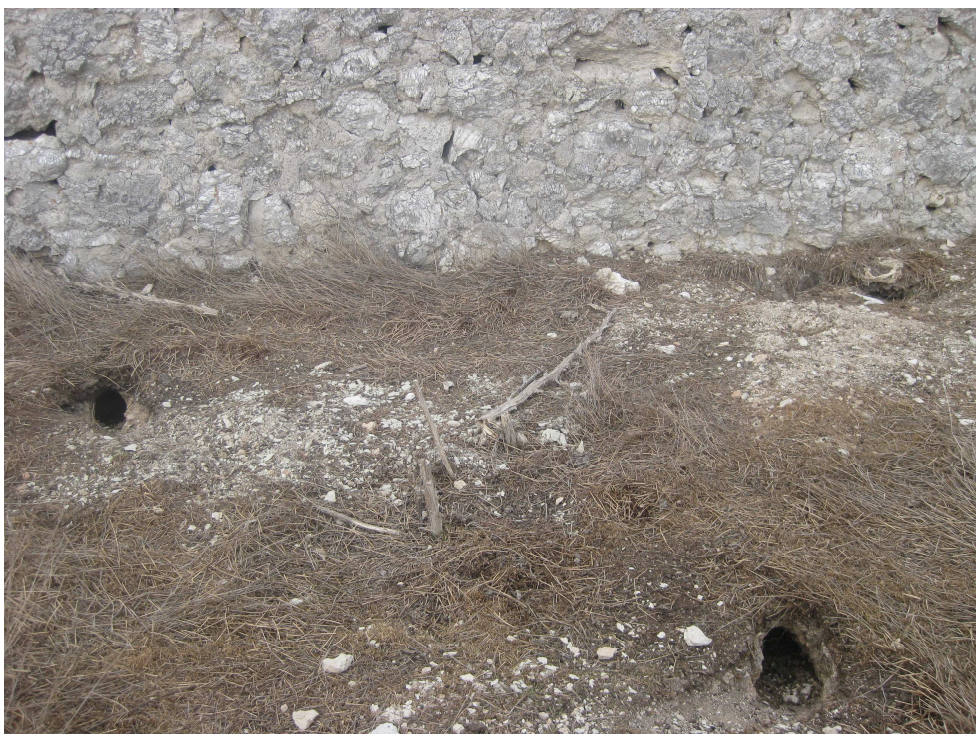
Fig. 145. Madrigueras de conejos en la base del muro. Choza de la Huerta Orea. Fotografía de la autora
