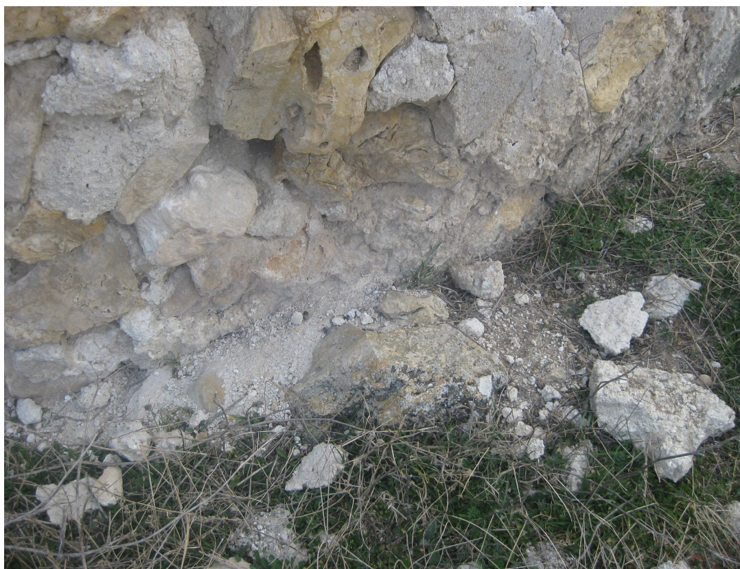
Fig. 143. Arenización de la argamasa y desprendimiento del revoco. Fotografía de la autora.
