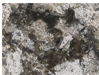
Fig. 195. Biodeterioro y arenización
