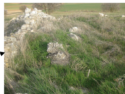
Fig. 213. Derrumbes y biodeterioro.
