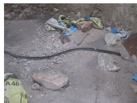
Fig. 196. Daño antrópico (basuras)
