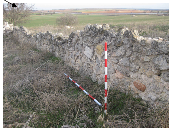
Fig. 215. Biodeterioro, pérdida de mampuestos
