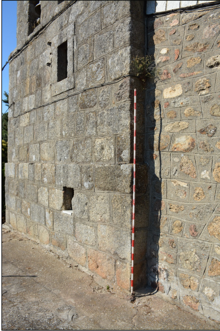
Figura XIV. Fotografía que muestra las diferencias de aparejo en el muro suroeste de la Iglesia de la Asunción de Nuestra Señora, Navahondilla (Ávila) (©Elisa Ruiz – Tagle 2022)
